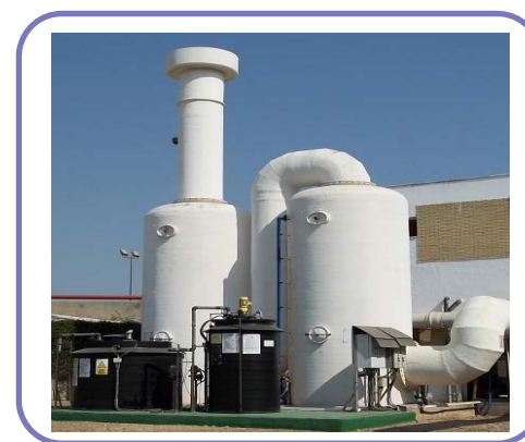
Sistema de desodorización
